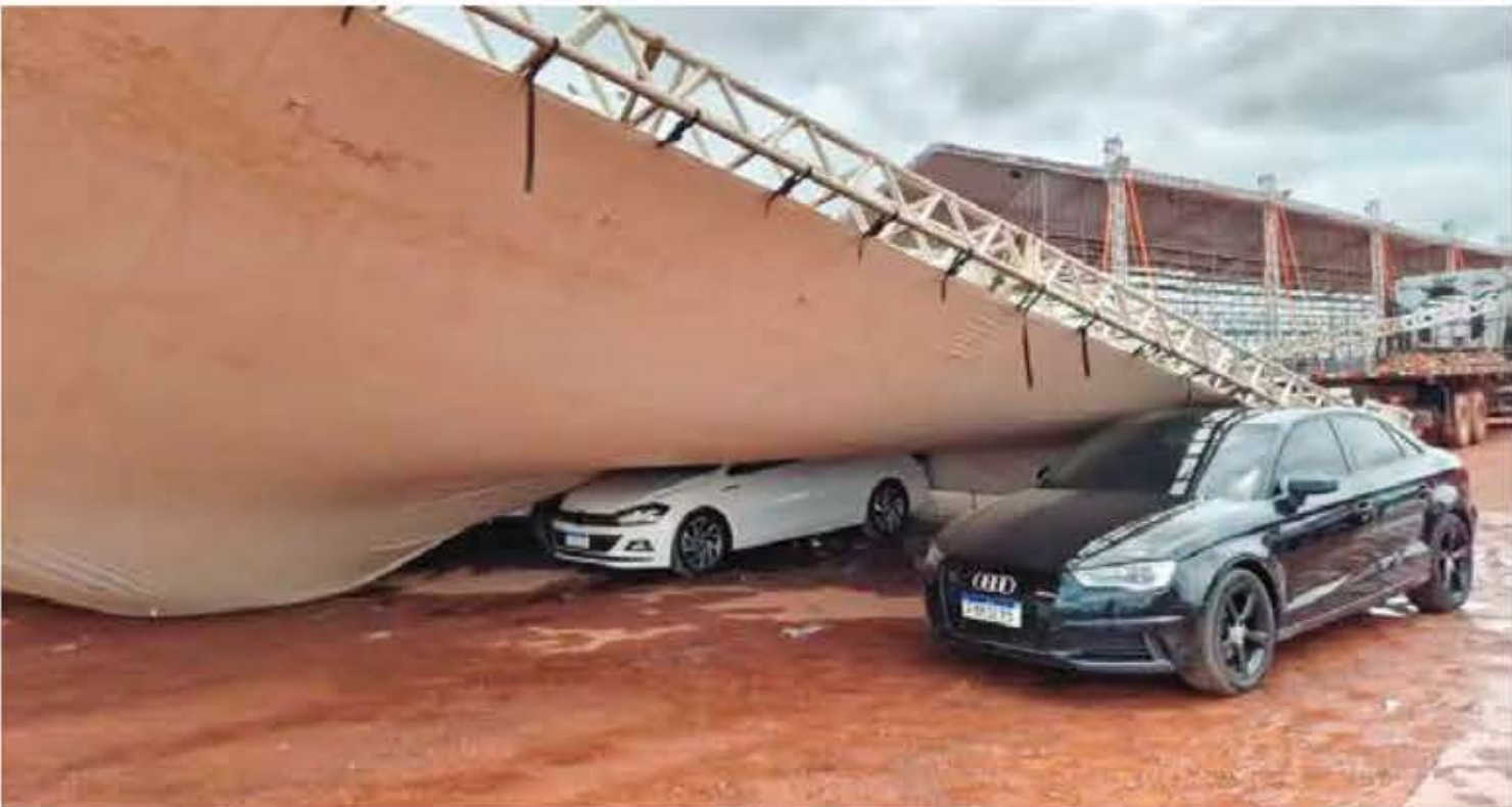
Estrutura de cobertura de uma das arquibancadas caiu sobre carros que estavam estacionados próximos
